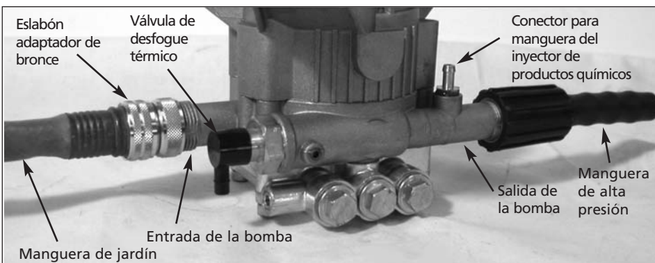
Figura 2 - Conexión de la bomba
